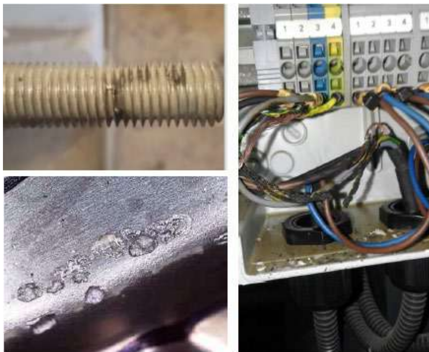
Рисунок 3.8.3 Последствия неправильного подключения «массы» сварочного аппарата
